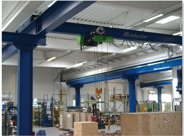
Einträger-Brückenlaufkran mit Unterflansch-Laufkatze als Hallenkran [Foto FS schuster]
